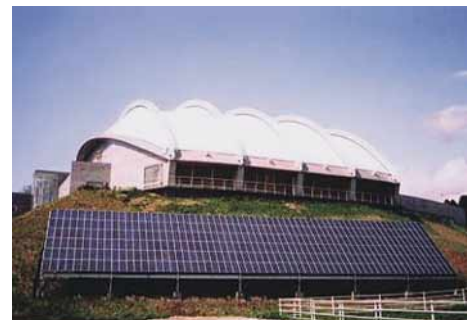
太陽光発電システム (20kW、NEDOフィールドテスト共同事業。岩手県一関市)
