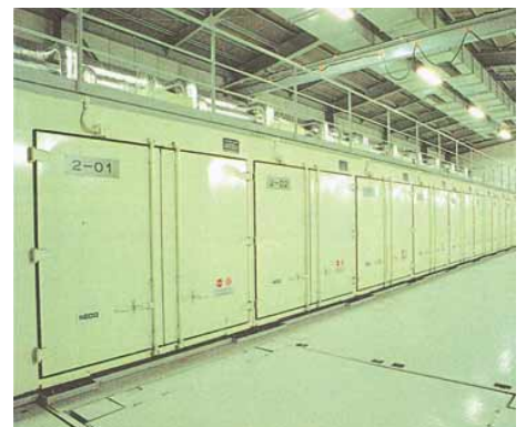
1.6-5: ナトリウム-硫黄電池1,000kW級パイロットプラント(電池室)
