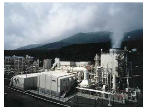
1.3-6: 八丈島地熱発電所
