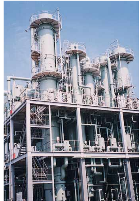
6-16：常減圧多重効用蒸留装置(出水工場)
