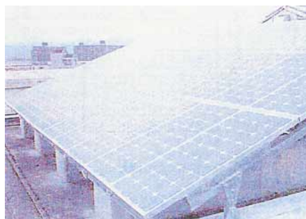
1.6-20 : 太陽光パネル
