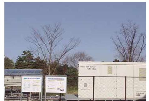
燃料電池 (200kW、NEDOフィールドテスト共同事業。長崎県佐世保市ハウステンボス町)
