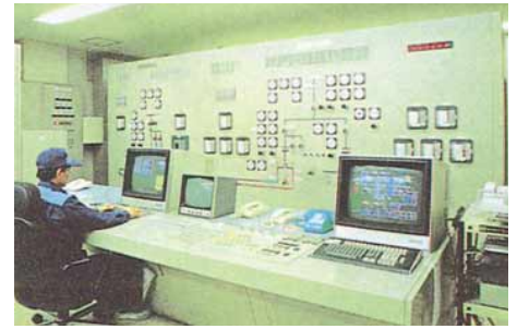
1.6-3: 亜鉛-臭素電池1,000kW級パイロットプラント(監視制御室)
