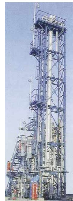
1.5-11 : 内部熱交換型蒸留塔 (HIDiC) ベンチプラント 木材化工機 (株)、丸善石油化学 (株)、関西化学機械製作 (株)
