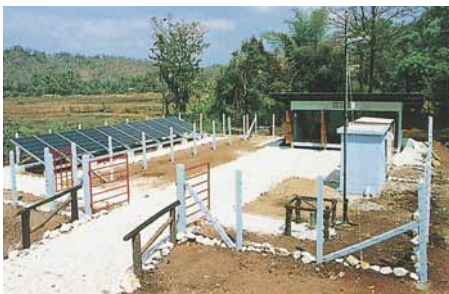
3-3：バッテリーチャージステーション用太陽光発電システム実証研究施設（タイ）
