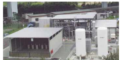
1.2-11 : 200kW級内部改質方式スタック試験設備 (尼崎)
