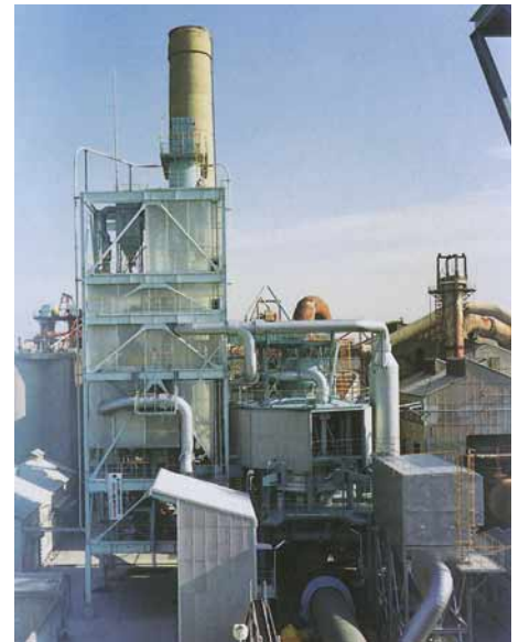
2.4-12:エコセメントプラント(愛知県渥美郡)
