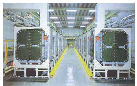
1.6-6: 亜鉛-臭素電池1,000kW級パイロットプラント(電池室)
