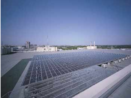
1.7-1：神奈川県海老名市の太陽光発電システム。富士ゼロックス(株)海老名事業所(100kW、産業等用太陽光発電フィールドテスト事業)
