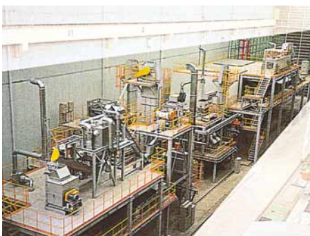
1.6-43：パイロットプラントの鳥瞰
