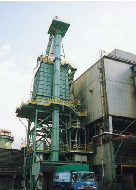
1.7-18：高炉吹込み設備
