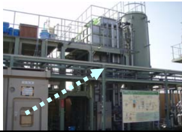
パイロットプラントUASB本体
