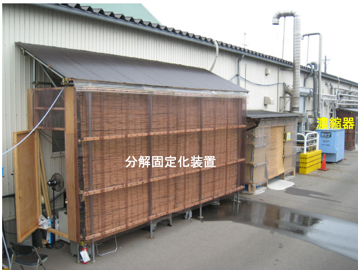
図 A-(7)-3 実証試験設備の全景
