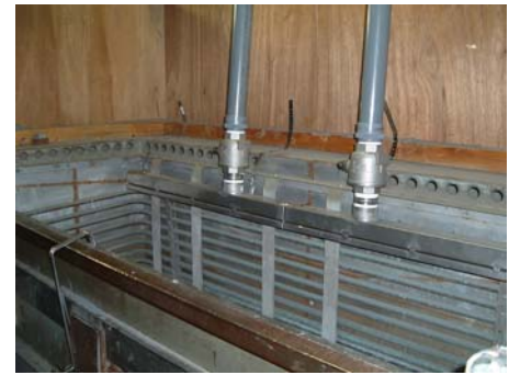
図 A-(2)-6 吸引ダクトの設置状況
