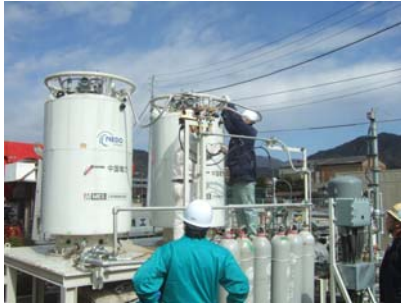
写真 1.1 小口需要家での試験の様子
