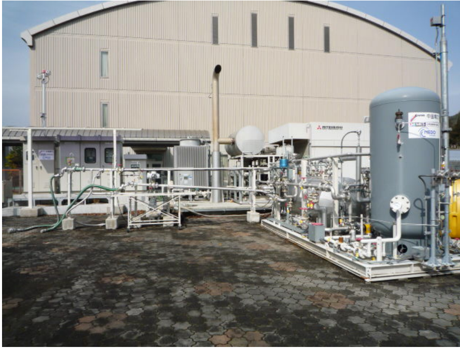
写真 2.2.2-1 大口需要家設備の全景写真
