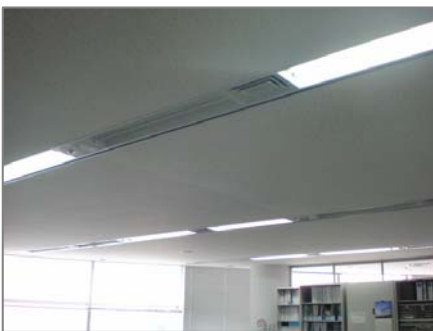
照明(LED)の間引き消灯を実施
