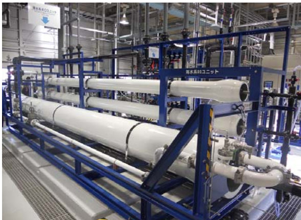
RO 処理装置
