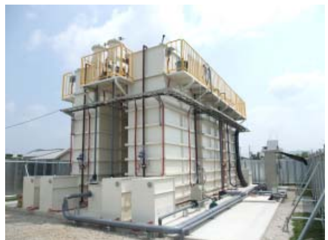
省エネ型MBRパイロット試験装置 (福崎浄化センターに設置)
