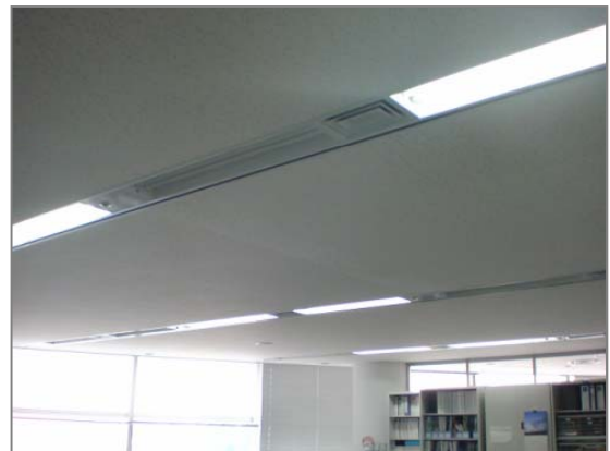
照明(LED)の間引き消灯を実施
