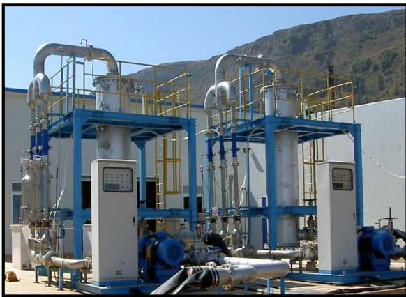
NACシステム プラントの一部
