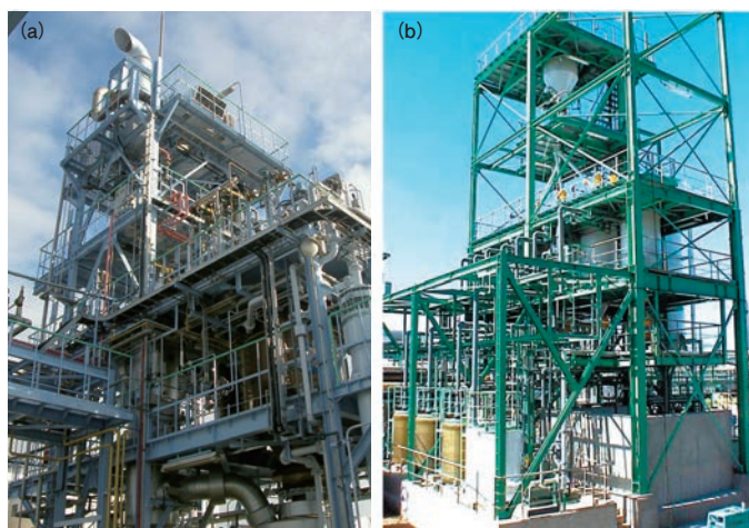
図1 液中燃焼法によるフロン等処理設備 (a)液中燃焼炉(ダイキン工業株式会社淀川製作所) (b)後処理設備(旭硝子株式会社 鹿島工場)
