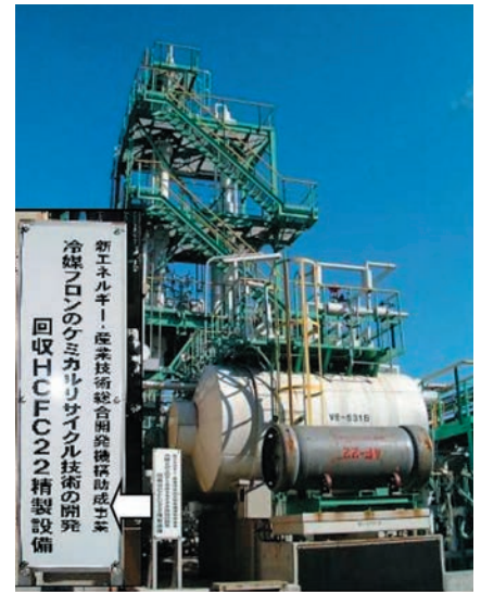
図3 冷却精製設備
