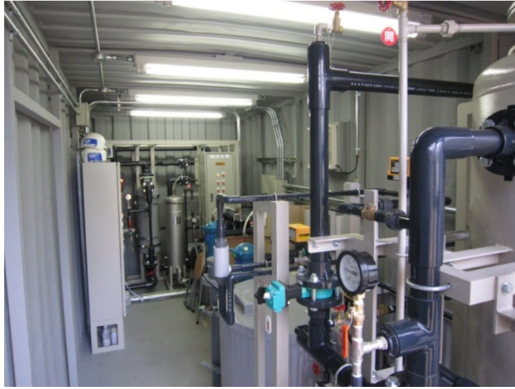
写真 5-1 水質制御装置
