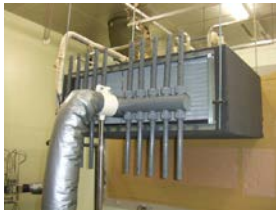
室内機の外観
