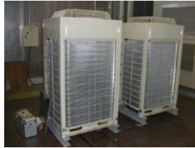
室外機の外観
