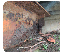
点検障害物 (土砂・劣化塗膜等)
