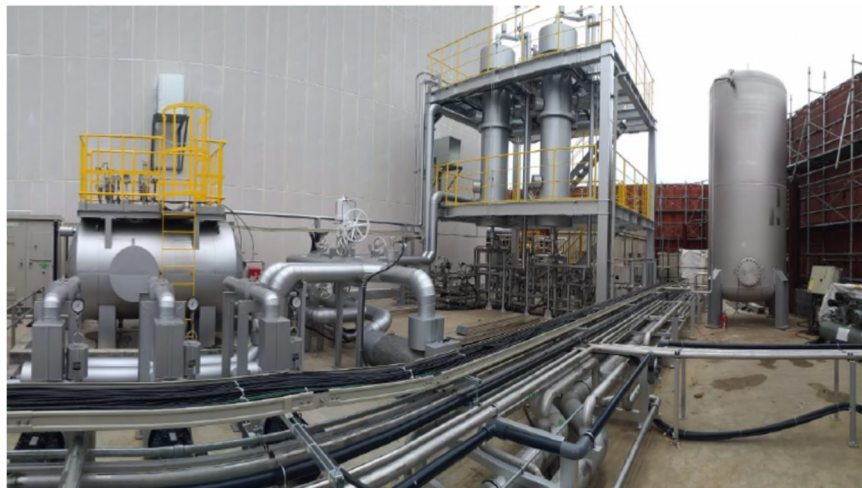
図 1-8 メタネーション設備
