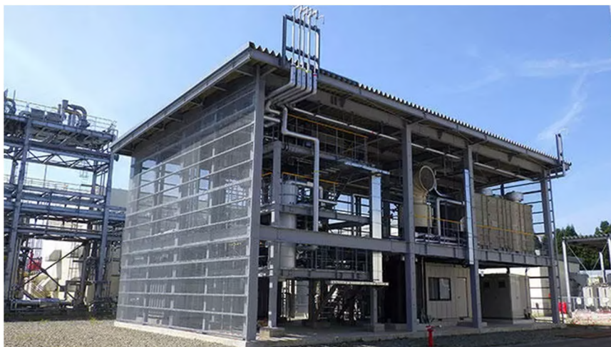
図 1-7 メタネーション試験設備
