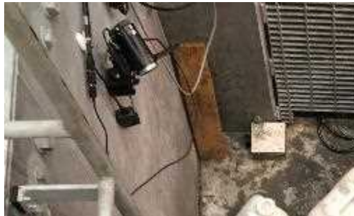
図 1-8-3.14 ピット内モニタ及び映像撮影用ビデオカメラの例
