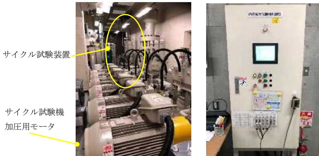
図 1-8-3.11 サイクル試験装置外観(左) 及びサイクル試験装置制御盤外観(右)
