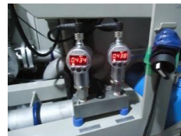
冷却水ライン/圧力計
