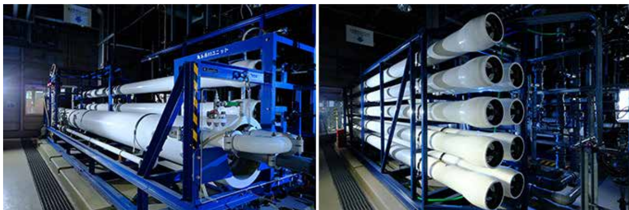
写真4 「ウォータープラザ北九州」に設置された海水RO膜(左)と、下水RO膜(右)
