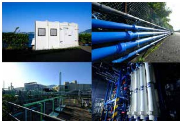
写真 2 北九州市小倉北区西港町にある「ウォータープラザ北九州」。関門海峡に面した海水取水口（上段左）、取水された海水（上段右）は隣接する下水処理場（下段左）の脇を通して、新プラントの前処理工程へ（下段右）、この工程後、海水は下水処理工程からの排水で希釈される
