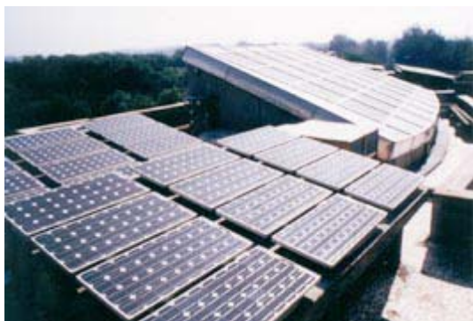
屋根に設置された太陽光発電システム
