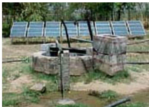
太陽光発電ポンプによる井戸水汲み上げ
