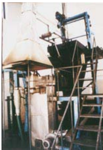
木質バイオマスガス化炉
