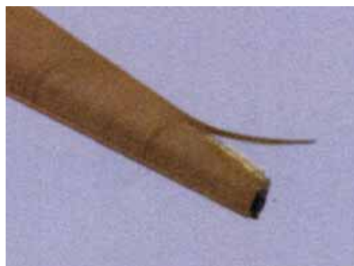
図D.5 落雷によりブレード先端部が破損した事例
