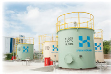
■タンク 水素貯蔵能力：20 m 3 -MCH タンクに約 10,000 Nm 3 -H 2 貯蔵（1週間分）
