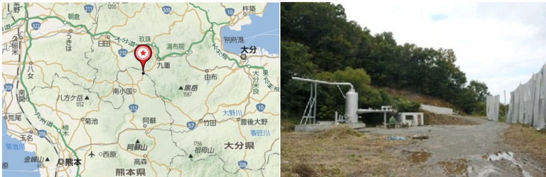
図Ⅲ(2.4)-3 熊本県小国町地熱発電設備
