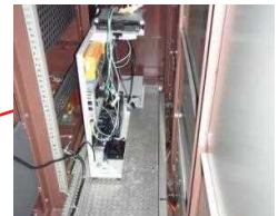
傾斜計、加速度計 PC記録器他 (内部)
