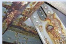
支柱のさびが進行
