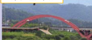
中国 過積載車両による橋梁の崩壊
