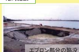
エプロン部分の陥没
