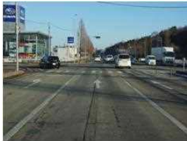
コンクリート舗装ひび割れ
