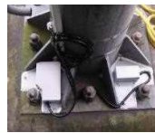
加速度計、傾斜計 (基部)
