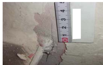
写真 がセット端部に発生したき裂
