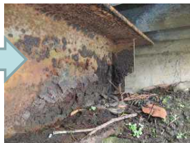
主桁 鋼材腐食
