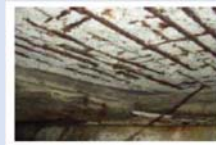
塩害により鉄筋がむき出し
