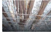
健全度Ⅳ事例：PC桁のケーブル破断
