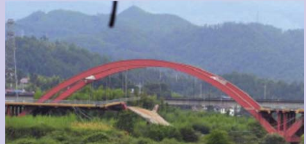
中国 過積載車両による橋梁の崩壊
