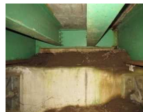
図Ⅲ-【③-(1)-4】- 4 桁端部の堆積土砂
