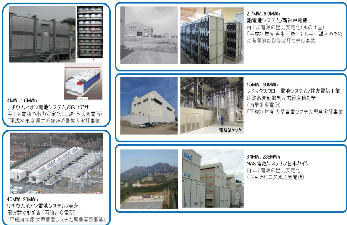
図 I -12 日本に導入されている大規模蓄電システムの例
