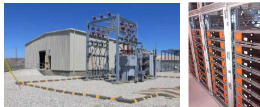
8MW/32MWh リチウムイオン電池システム/LG化学 (カリフォルニア州; Tehachapi Wind Energy Storage Project)
