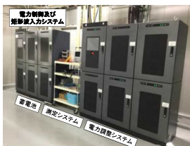
検証のために構築した蓄電池システム
