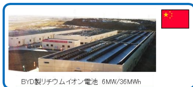
図 I -24 張北プロジェクトで導入されたリチウムイオン電池システム
