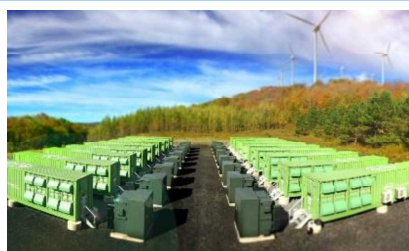
31.5MW/12MWh リチウムイオン電池システム/BYD (イリノイ州; Grand Ridge Energy Storage Project)
