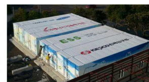
KEPCO済州島スマートグリッド実証 サムスンSDI製リチウムイオン電池 4MW/8MWh
