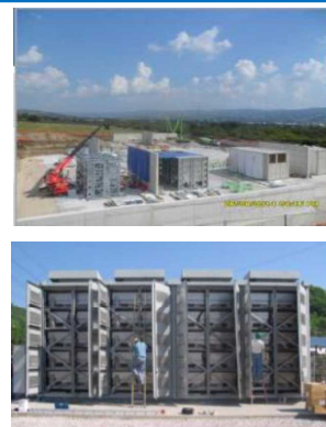
12MW/96MWh NAS電池システム/日本ガイシ 送電混雑解消 (Terna S.p.A. Flumeri Plant) 「Terna SANCプロジェクト」
