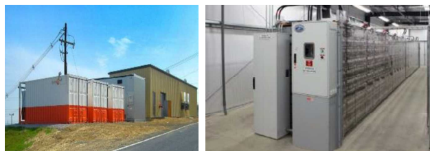
3MW/2.15MWh 鉛蓄電池システム/Ecoult (ペンシルバニア州; Grid-Scale Energy Storage Demonstration)
