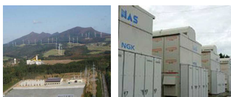
34MW/238MWh NAS電池システム/日本ガイシ 再エネ電源の出力安定化 (六ヶ所村二又風力発電所)
