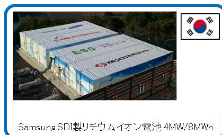
図 I-25 済州島スマートグリッド実証で導入されたリチウムイオン電池システム
