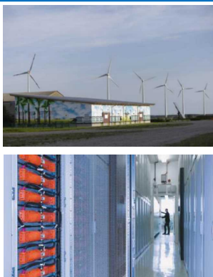
10MW/10.8MWh リチウムイオン電池システム/LG化学 再エネ電源の出力安定化 (Feldheim Regional Regulating Power Station) 「Feldheim Regional Regulating Power Station プロジェクト」
