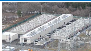
40MW/20MWh リチウムイオン電池システム/東芝 周波数変動抑制(西仙台変電所) 「平成24年度 大型蓄電システム緊急実証事業」
