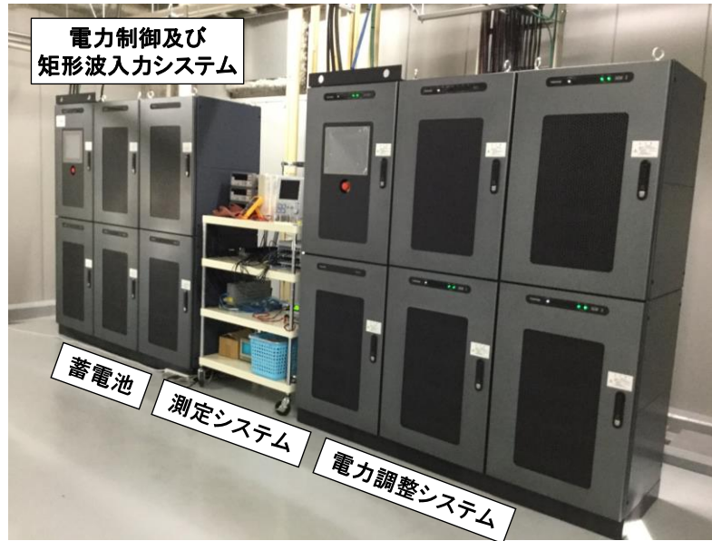
図Ⅲ-44 劣化診断技術検証のために構築した蓄電池システム
