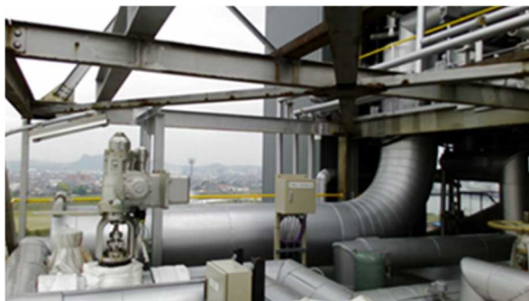
図 45 保温を巻かれた大径管
