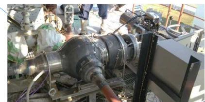
タービンバイパス弁 (ABB日本ベレー)
