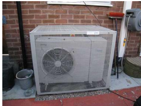
室外機の外観
