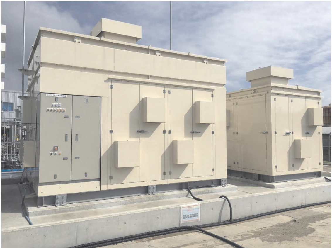
写真 1 「建設完了時の設備」
