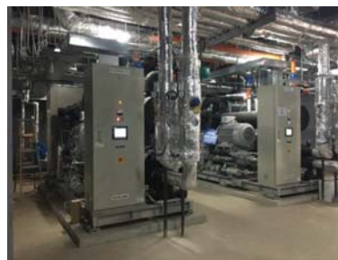
熱回収ヒートポンプ(前川製作所) 240kW×2台
