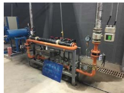
地中熱利用設備ポンプ
