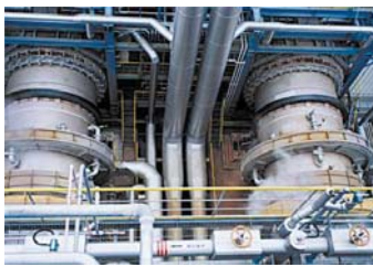
鹿島共同再資源化センター(茨城県)
