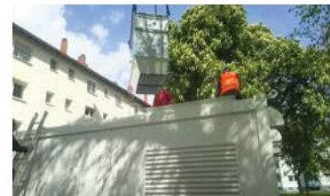
サイレンサの設置 (インバータのスイッチングの際の高周波音、 ファンの動作音の低減)
