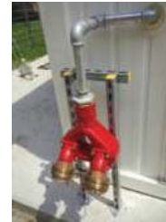
コンテナ外からの注水口
