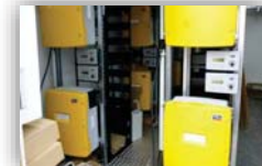
蓄電池インバータ・蓄電池
