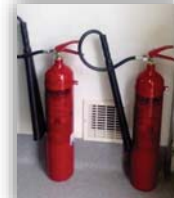
CO2ガス消火器
