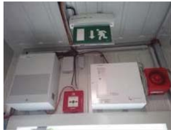
消防署への通信装置
