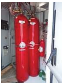
自動消火設備用ガスボンベ
