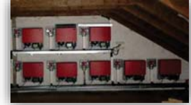
PVインバータ (集合住宅屋根裏)
