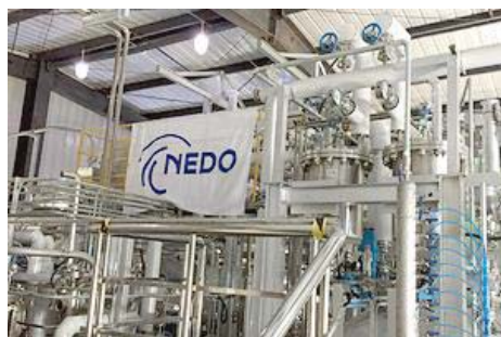
エタノール製造設備
