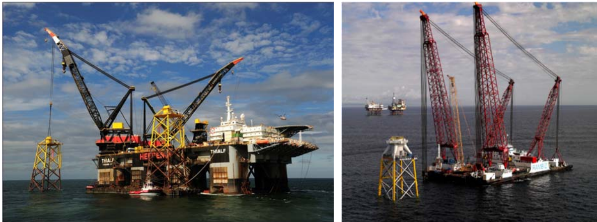
図Ⅲ.6.2-32 ジャケットの吊り上げ（左図：Ballast Nedum, 2011）と据付（右図：Robertson, 2008）状況
