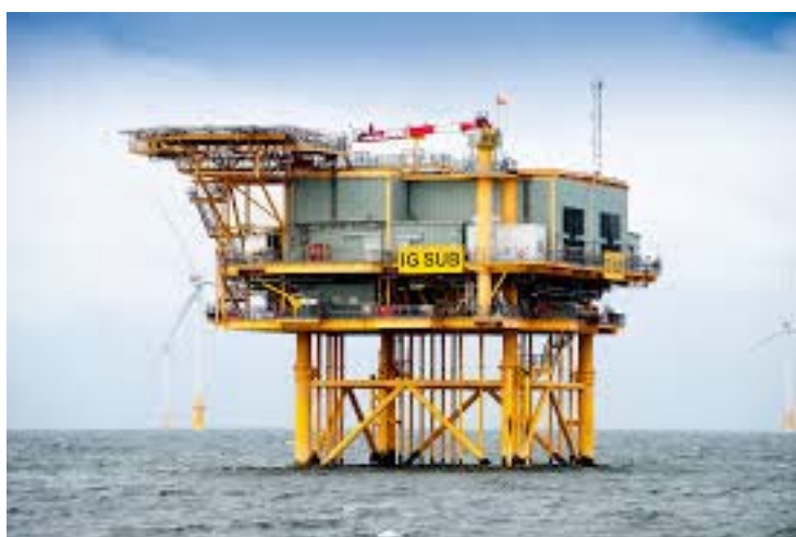
図Ⅲ.6.2-57 洋上変電設備の例
