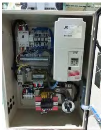
(d) 操作盤外観
