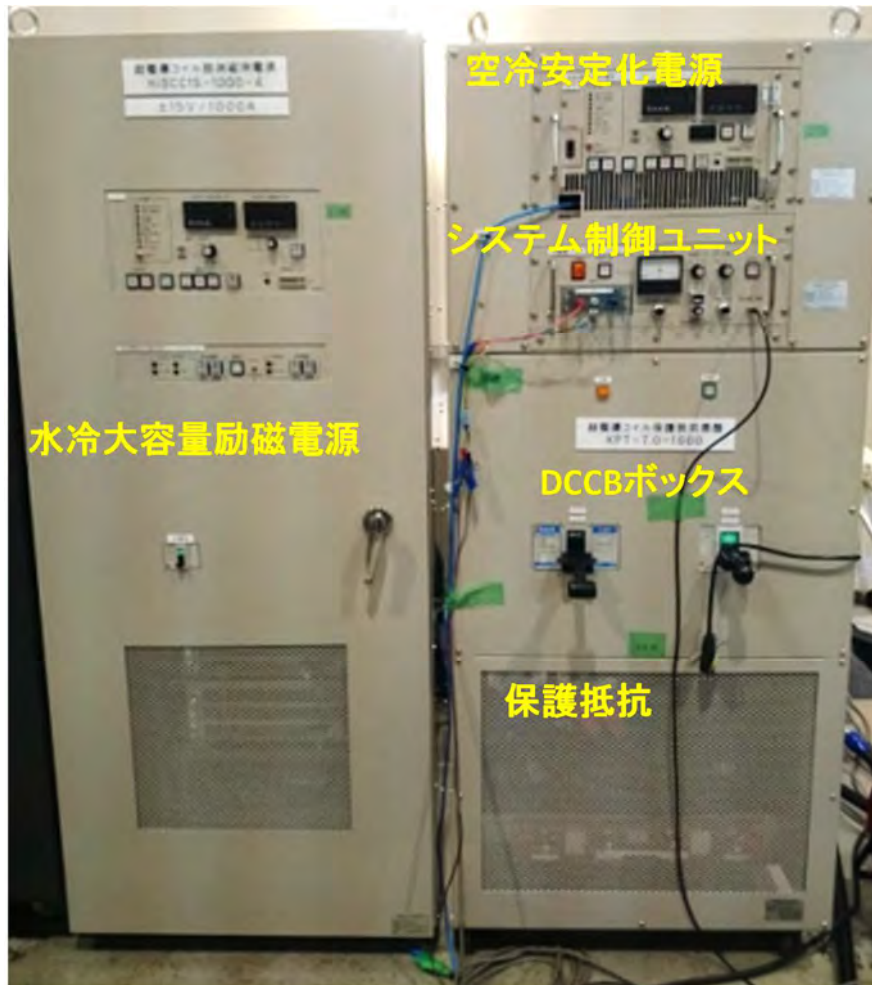
図 2.2.2-16 MRI 用省電力高安定励磁電源システムの外観写真
