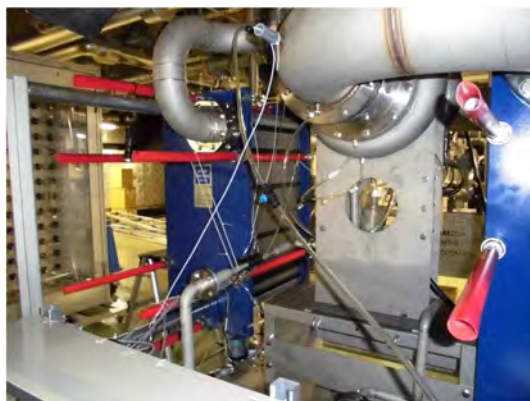
図Ⅲ(2.4)-12.TIF実証試験装置外観写真
