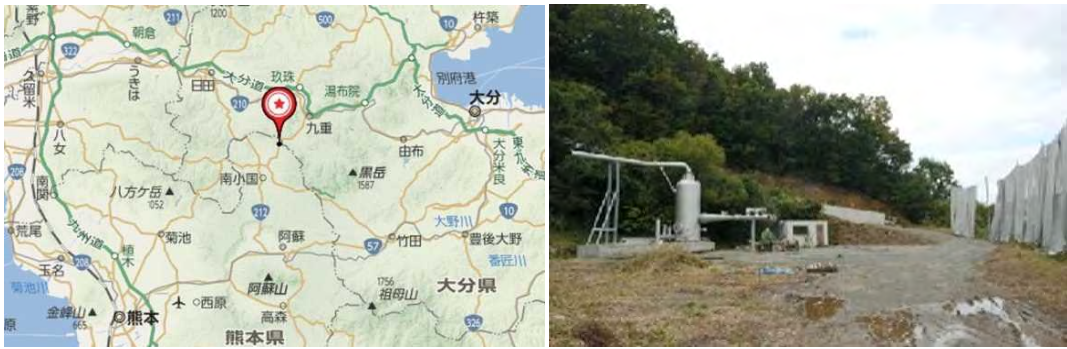
図Ⅲ(2.3)-3 熊本県小国町地熱発電設備
