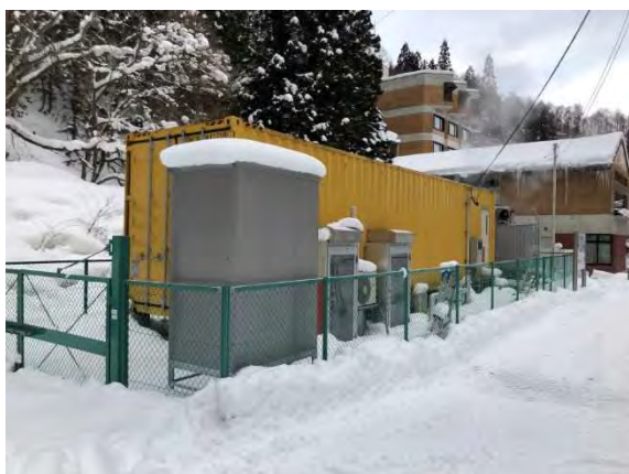
図Ⅲ(2.4)-13.実証試験設備全体
