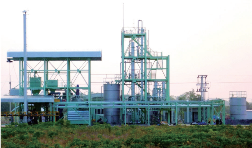
バイオエタノール製造プラント概観 / พังของโรงงานผลิตไบโอเอทานอล
