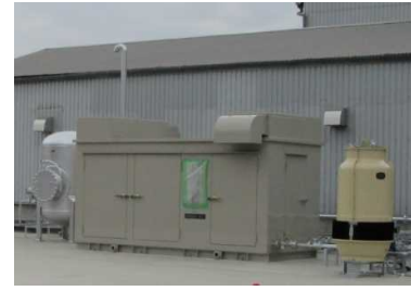
都市ガス圧縮機
