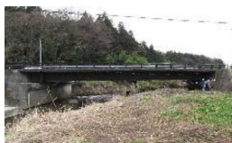
NEC(福島県郡山市) 道路橋のモニタリング。 卓越振動数の変化から劣 化を検出
