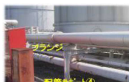
日立パワー(広島県大竹市) プラント配管点検用ロボットシ ステム。X線、中性子線を用い て、配管保護材の水分量、鋼 管の減肉を計測
