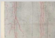
ひび割れ モニタリング
