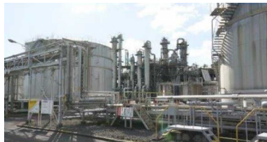
配管の腐食検出
