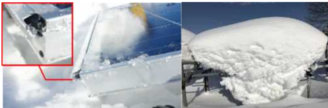
図Ⅲ-2-①-(2)-1 滑雪によるフレーム部の破損例
