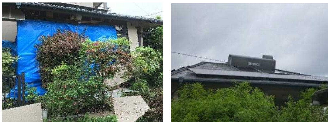
図Ⅲ-2-④-(4)-11 (左) 1階部分は激しく損傷 (右) 温水器がずれたことでパネルに歪み
