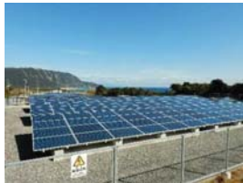
大原太陽光発電所
