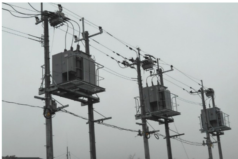
図 2-51 SVC3 台(300kVA×3)が隣接して設置されている様子(撮影:東大)
