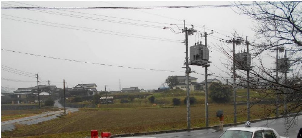
図 2-52 SVC が設置された場所の周辺の様子(撮影:東大)
