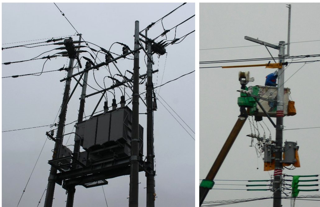
図 2-53 3 MW の柱上配電塔の例(左)と、電柱延伸での 22 kV 線路設置工事例(右) (撮影:東大)
