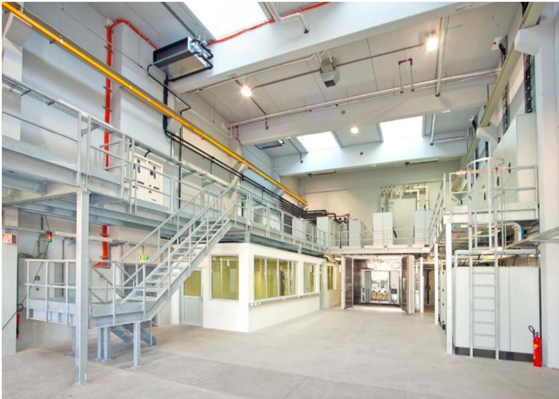
図 2-32 AIT の PV 系統連系インバータ試験設備の外観[2-37]
