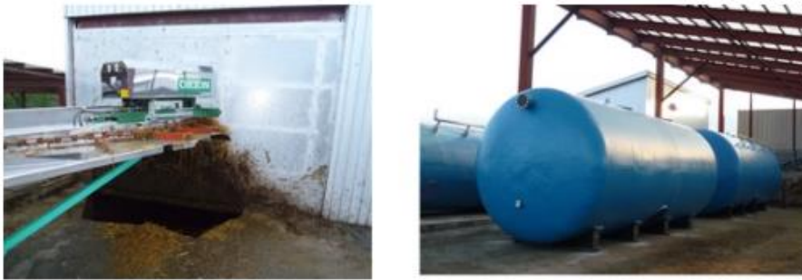
図 2.4.3 原料自動投入装置・原料前処理装置と、FRP 製メタン発酵槽（高温乾式） （出所）NEDO ニュースリリース
