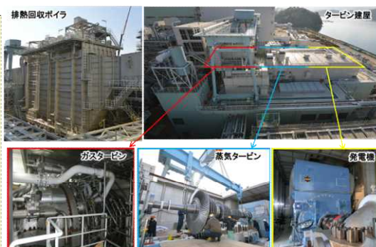
図 3-11 複合発電設備
