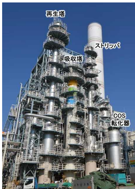
図 3-8 ガス精製設備
