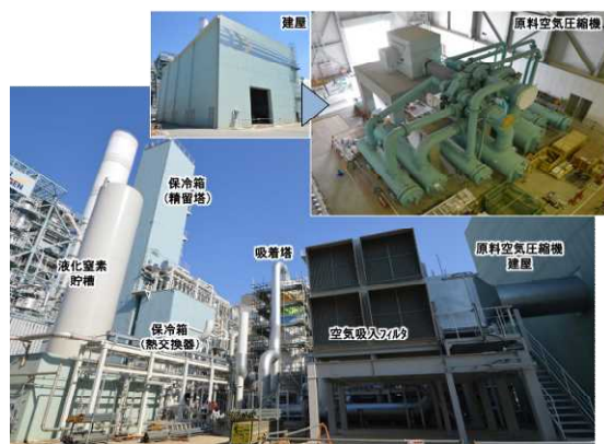
図 3-15 空気分離設備
