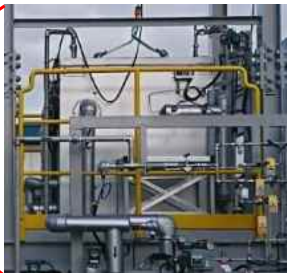
膜エレメント設置部
