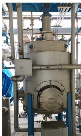
図 2-2-6-3-5 酵母前培養槽外観
