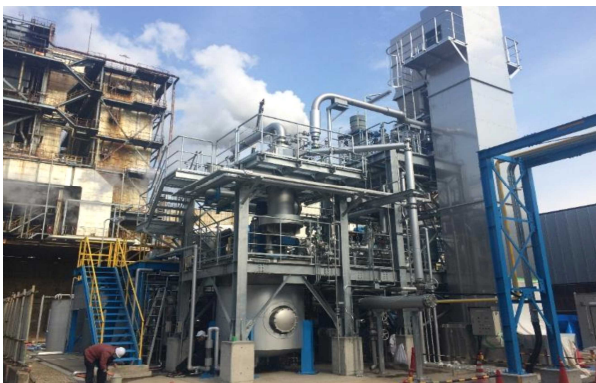
パイロットプラント外観
