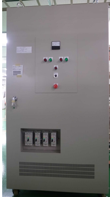
図 3-4-186 10kV 器用制御装置
