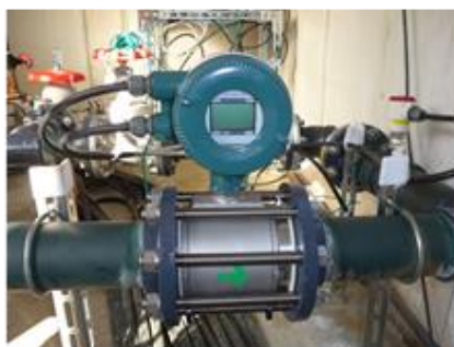
図 II-1：受託者が先行研究開発を通じて開発した「簡易遠隔温泉モニタリング装置（実証試験器）」
