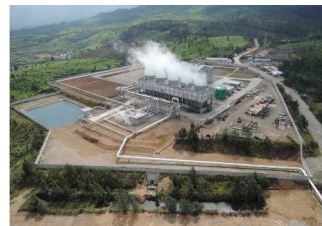
パトハ地熱発電所(インドネシア) 定格出力 60MW 国営地熱発電会社であるGDE社による運営管理
