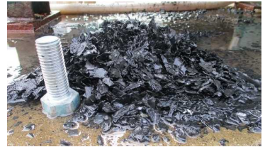
熱交換器入口に集積した剥離スケール
