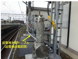
写真1 敷設した超電導き電ケーブル
