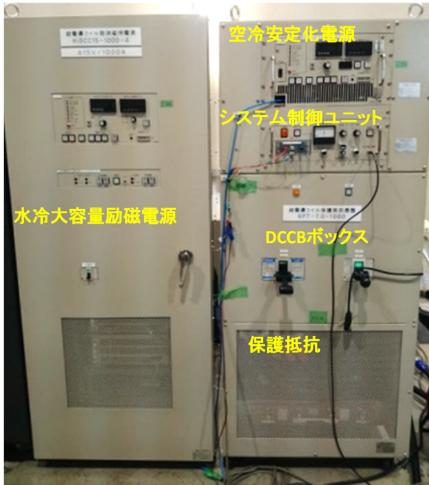
図 2.2.1-19 MRI 用省電力高安定励磁電源システムの外観写真
