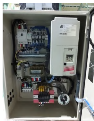
(d) 操作盤外観
