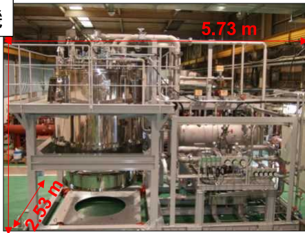
NEDO事業「高温超電導ケーブル実証プロジェクト」、 「次世代送電システムの安全性・信頼性に係る実証研究」の開発品
