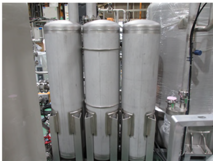
図 2.1.1-7 バッファタンク
