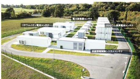
実証運転を開始した大規模ハイブリッド蓄電池システム
