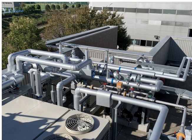
熱源水ループ配管
