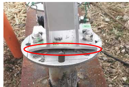
図Ⅲ-2-(ロ)-(i)-D-14 ベースプレート変形浮上り変形
