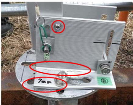
図Ⅲ-2-(ロ)-(i)-D-13 ベースプレート変形浮上り変形亀裂
