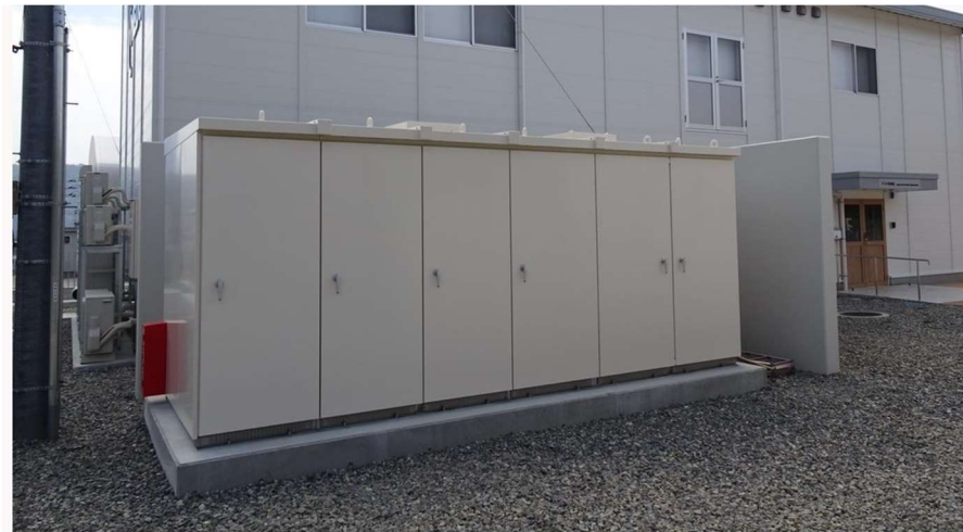
図 3.2.1.2-16 基礎研究・先導研究拠点のキュービクル(主電気設備)の竣工状況(2022年4月12日)
