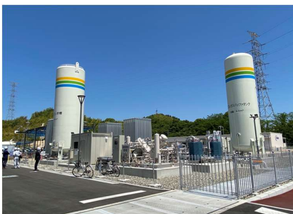
【A-1】CO 2 供給設備
