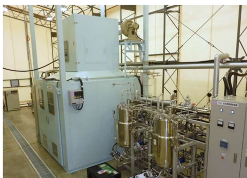
図 3.2.2.3-12 Gas-to-Lipids 一貫製造プロセス 手前から培地調製槽、H 2 チャンバー（内部に酢酸発酵槽設置）
