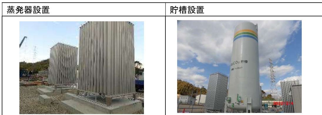
図 3.2.1.1-10 ①-3 CO 2 バックアップ供給設備
