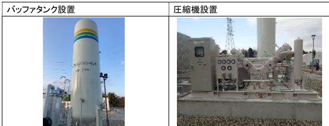
図 3.2.1.1-8 ①-2 CO 2 供給設備
