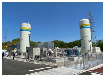
【A-1】CO 2 供給設備
