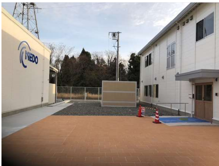
図 3.2.1.2-14 基礎研究・先導研究拠点外構部の竣工状況(共用棟と研究棟間のインターロッキングブロック)(2022年3月23日)
