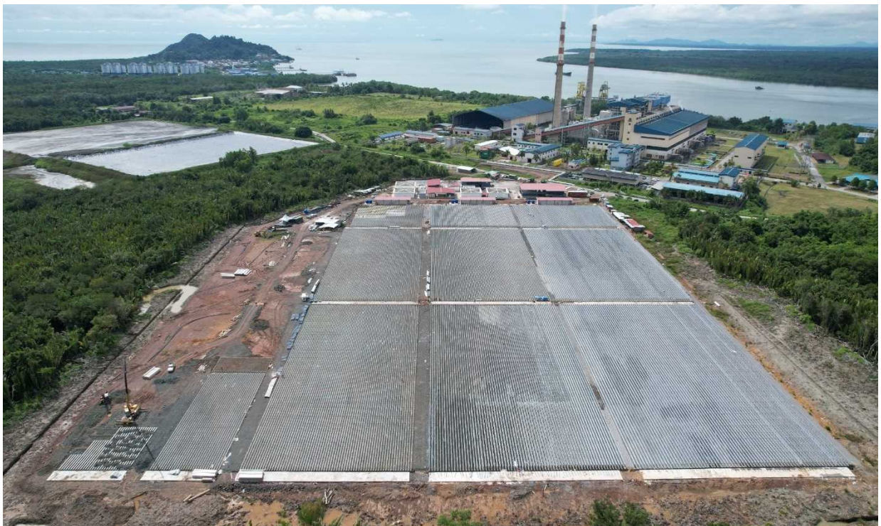
図2 2022 年 7 月における大規模微細藻類培養システム建設の様子。研究室、機械室、各種タンク類等の建屋類の多く(図の上部に位置する赤い屋根の建屋類)が建設され、また培養設備(PBR)の建設が進んでいることが確認される。
