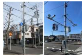
図 AI交通信号機の設置状況
