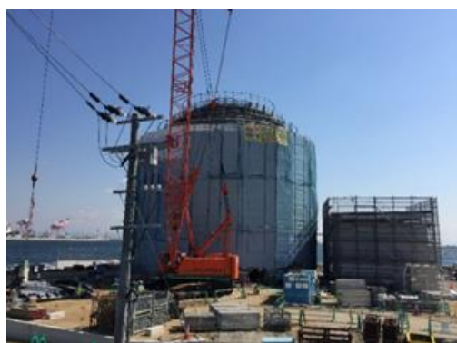
(a) 液化水素貯蔵タンク
