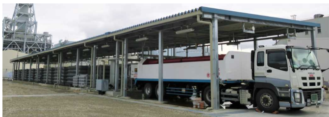
大容量水素供給設備
