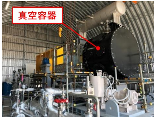
図3.現地試験時の圧縮機全景
