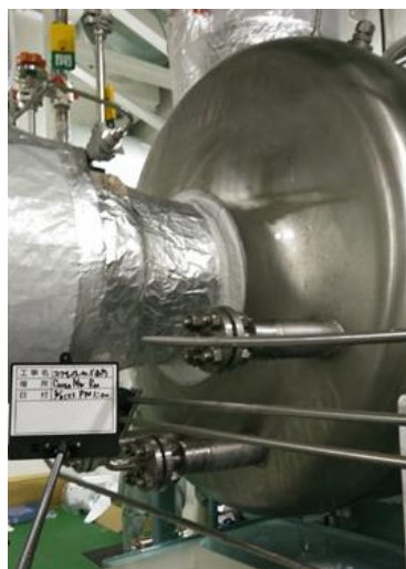
図 10 運転状態の気体水素圧縮機
